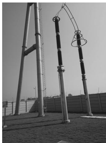
图1 襄阳某500 kV智能变电站避雷器(一相)
